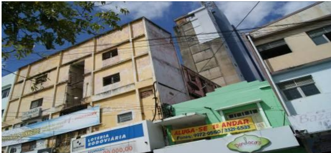
Figura: Perfil de Edifício com Fachada Depreciada. Fonte: Autor, 2013.
