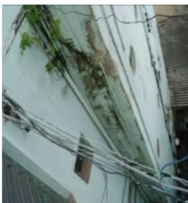
Figura 05: Infiltração, presença de vegetação em prédio central de Campina Grande PB. Fonte: Autor, 2014
