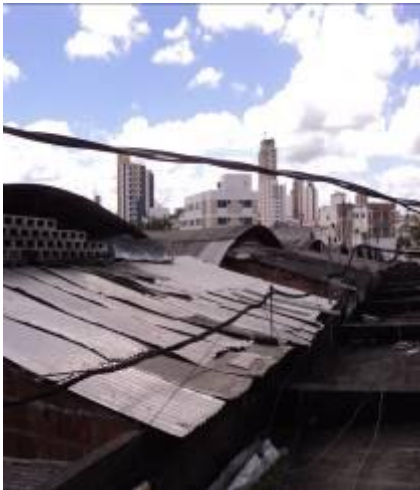
Figura 11: Estado da cobertura metálica externa. Fonte: Autor, 2013.
