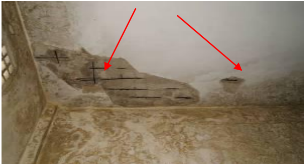
Figura 01: Ferragens expostas devido infiltrações na laje, encontrada em prédio central de Campina Grande PB. Fonte: Autor, 2014.
