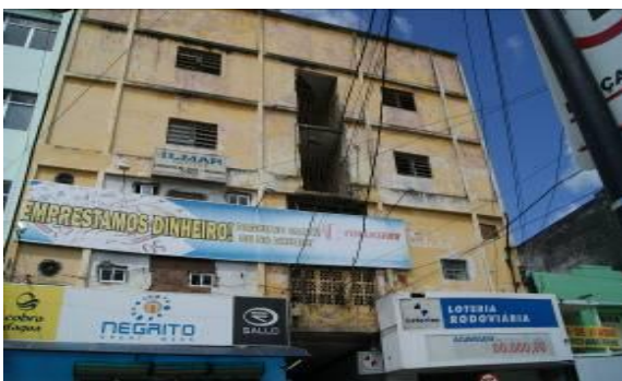
Figura 03: Estado de conservação da Fachada no Centro de Campina Grande PB. Fonte: Autor, 2014.
