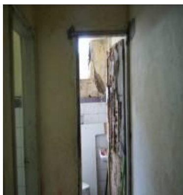
Figura 06: Estado de conservação de madeiramento com presença de cupins. Fonte: Autor, 2014.
