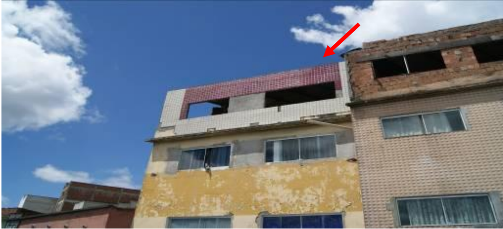
Figura: Perfil de Edifício com Descolamento de cerâmicas. Fonte: Autor, 2013.
