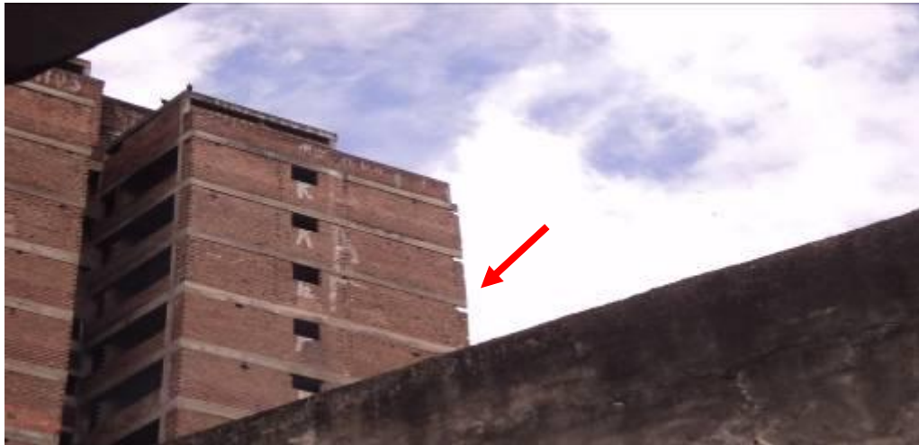
Figura: Perfil de Edifício com Descolamento de Alvenaria. Fonte: Autor, 2013.
