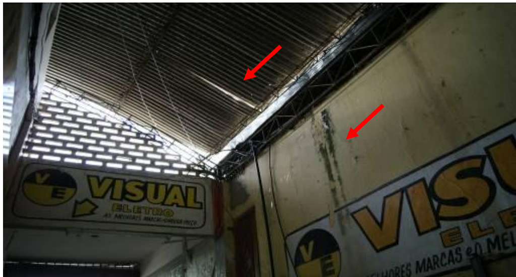
Figura: Detalhe da cobertura com Goteiras na Região Central de Campina Grande. Fonte: Autor, 2013.
