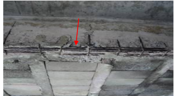
Figura 02: Ferragens expostas na viga, encontrada em prédio central de Campina Grande PB. Fonte: Autor, 2014.
