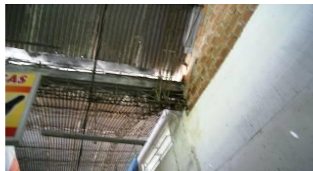
Figura 04: Estrutura metálica deteriorada na região central de Campina Grande PB. Fonte: Autor, 2014.
