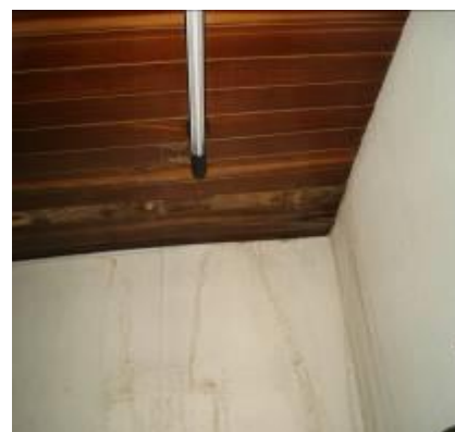
Figura 07. Forro tipo lambril com presença de cupins e infiltrações. Fonte: Autor, 2014.
