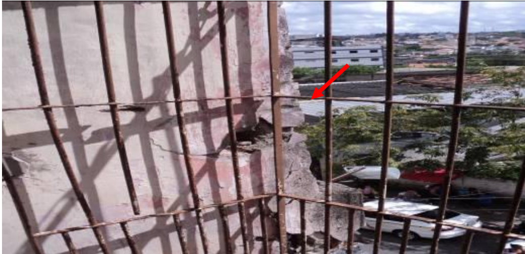
Figura: Detalhe da Amarração do Gradil de Proteção Degradado. Fonte: Autor, 2013.
