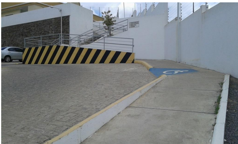
Figura 04. Vista da rampa de acesso aos apartamentos do Residencial Dona Lindú IV Fonte: Tailine Mendes
